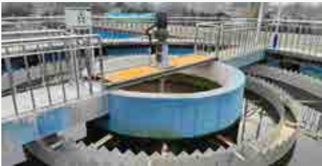
杨村煤矿生活污水处理系统
