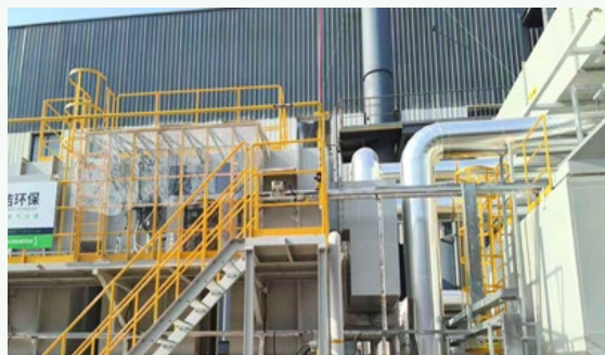
喷漆线VOCs治理改造
