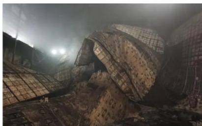
被大火烧毁的厂房
