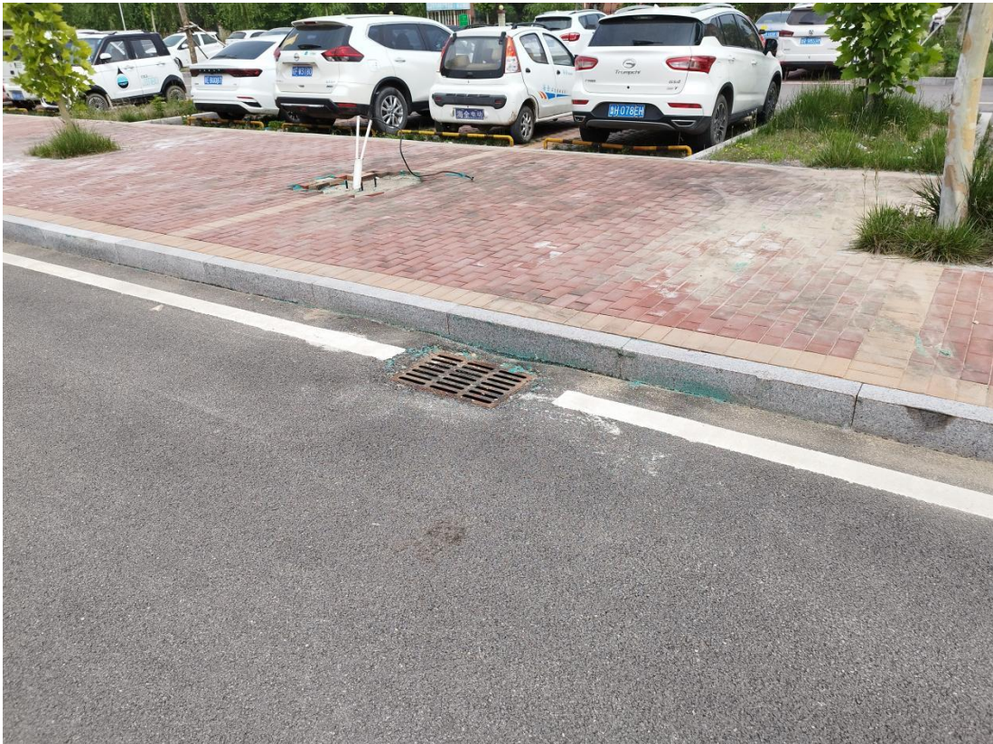
南部停车场排水管入水口
